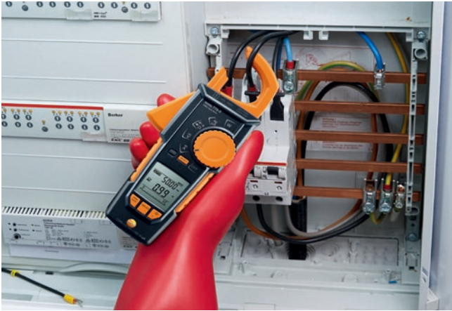
测量开关柜电流
