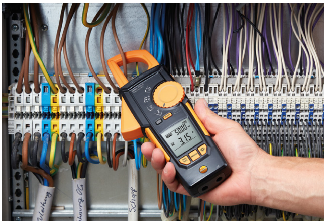
Stroommeting bij de schakelkast.
