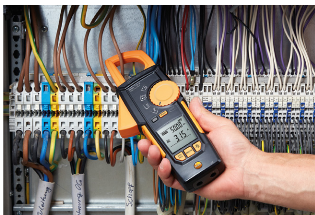
Mesure de courant sur une armoire électrique.
